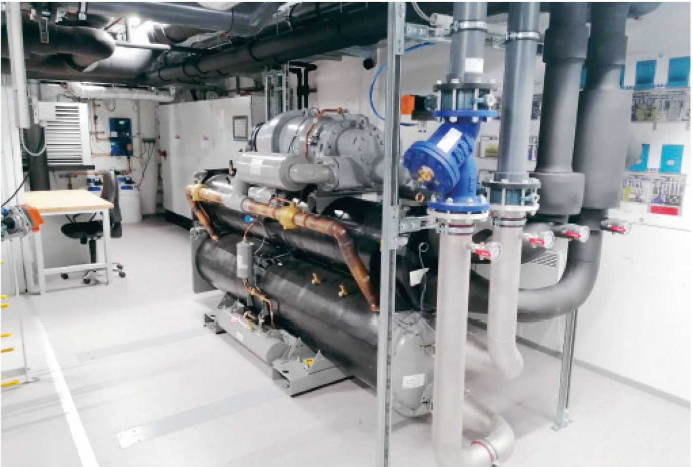
Hocheffiziente Kältemaschinenteknik mit dem Kältemittel R515B bildet die Grundlage für ein zukunftssicheres Kältekonzept.
