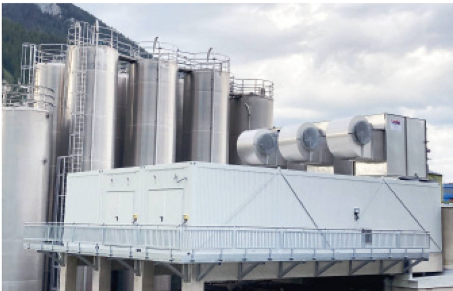
Die komplette Einheit bringt mehr als 300 Tonnen Betriebsgewicht auf die Waage. Zur Aufstellung der drei Rückkühlwerke wurde platzsparend das Dach der Container genutzt.
