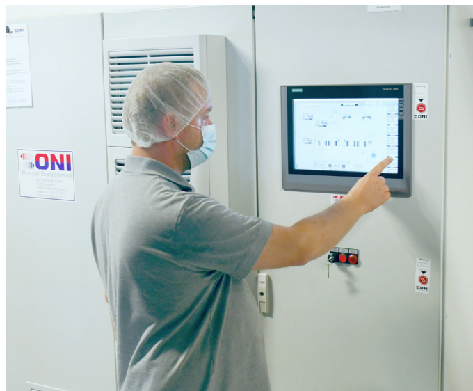
Am zentralen Schalt-schrank laufen alle organisatorischen Fäden der Medienversorgung zusammen. Manfred Schägner verschafft sich ein Bild über die aktuelle Betriebssituation und passt Parameter an die Bedarfssituation an.
