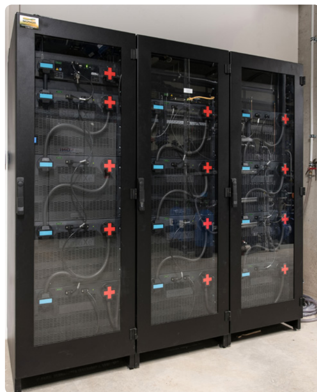
Ein weiterer Baustein zur Senkung der Energiekosten: Pufferspeicher zum Abfangen von Spitzenlasten der 1000 kW-Solaranlage auf den Dächern der Firmengebäude. (Bild: Meinolf Droege)
