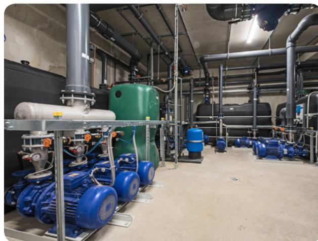
Trotz hoher Leistung ist die Oni-Anlage sehr schlank und übersichtlich aufgebaut. (Bild: Meinolf Droege)
