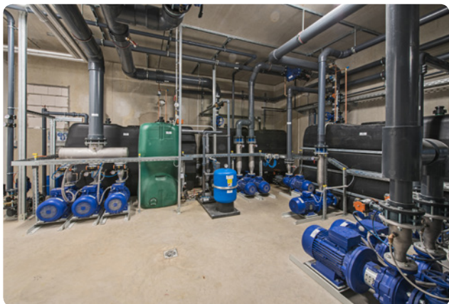
Die von Oni eingesetzten Motoren entsprechen je nach Einsatzgebiet den Standards IE 4 oder IE 3. Viele Komponenten sind redundant ausgelegt, die Gesamtanlage mit anderen gekoppelt. (Bild: Meinolf Droege)
