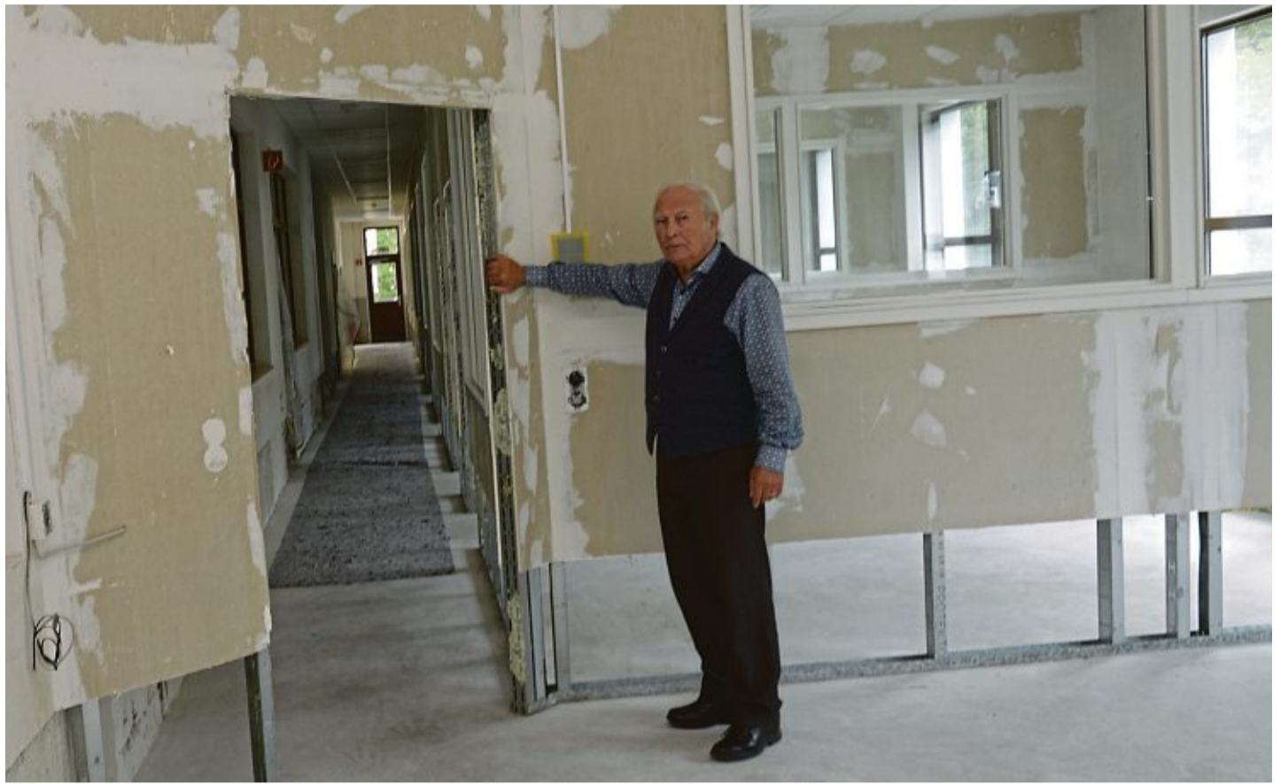
Wie in einem Rohbau sieht es im Bürobereich aus, den Wolfgang Oehm zeigt. Böden, Wänden und die Elektrik werden erneuert. Fotos: Lenzen
