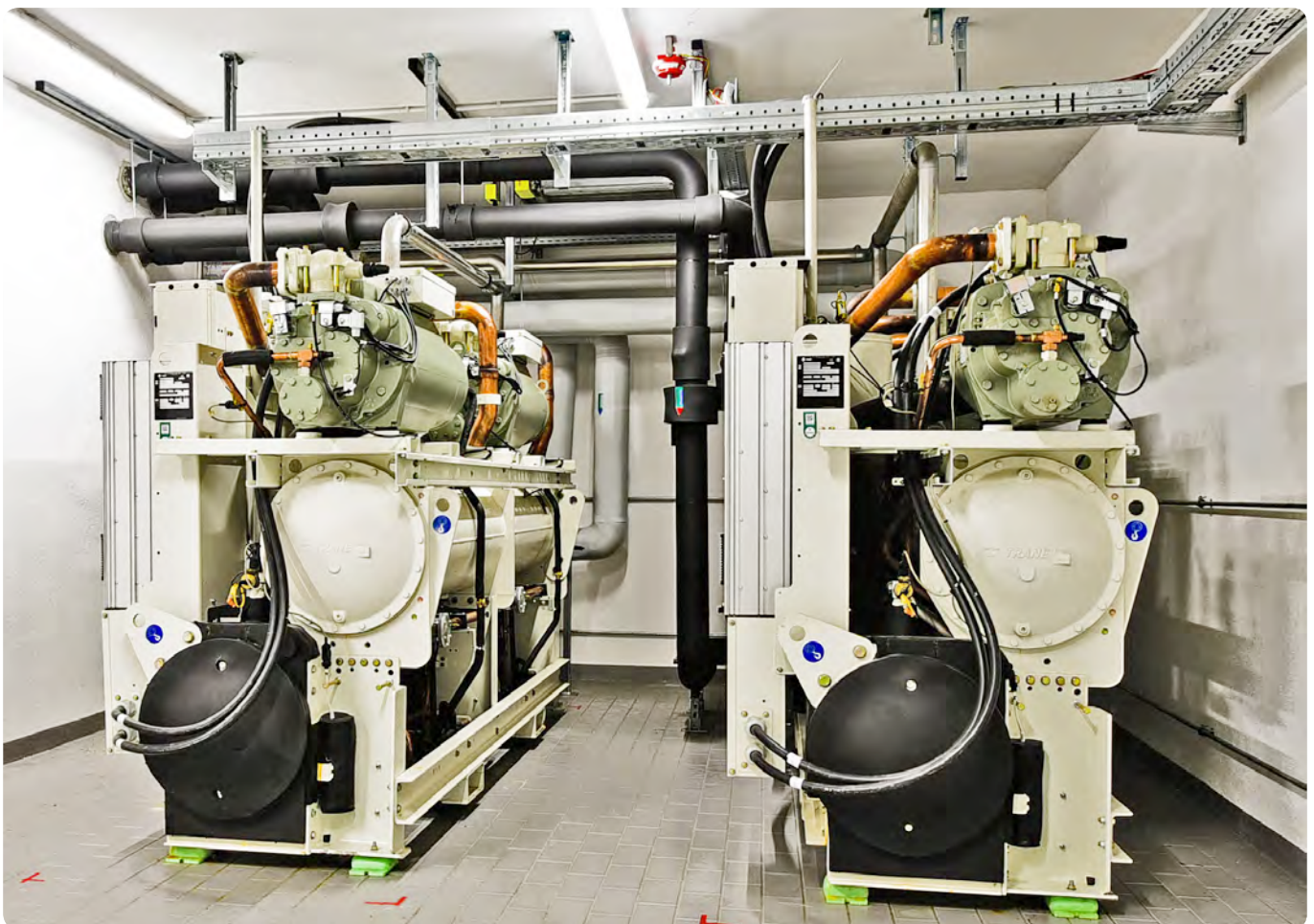
Hier schlägt das Herz der Heinlein-Kältetechnik: Wenn Freikühler und Kühlturm nicht ausreichen, übernehmen die beiden hocheffizienten, wassergekühlten Maschinen mit Kältemittel 1234 – eine davon frequenzgeregelt zur präzisen Anpassung an den tatsächlichen Bedarf. (Bild: Meinolf Droege)
