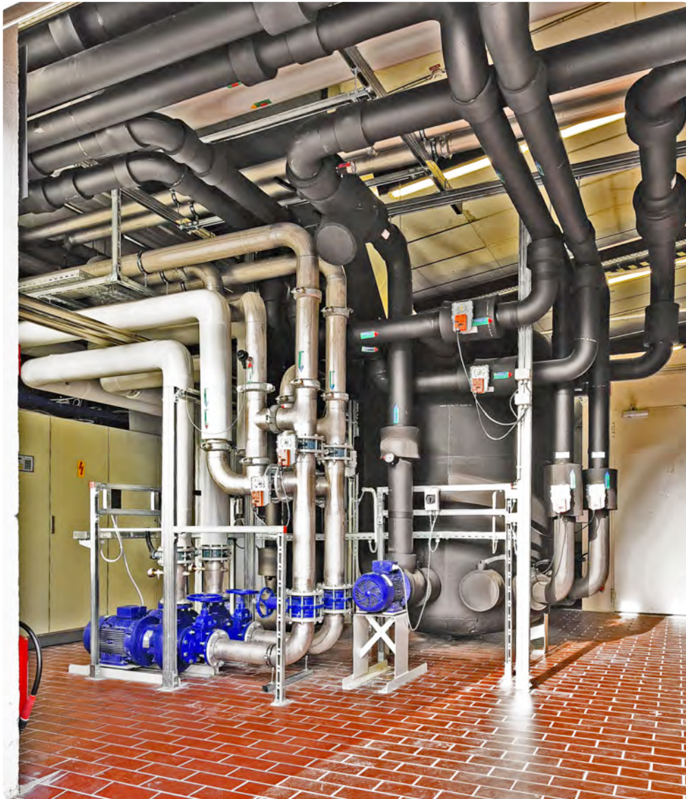
Knotenpunkt – der 22 Kubikmeter große Pufferspeicher im Hintergrund nimmt die Energie unter anderem aus Maschinen- und Werkzeugkühlung auf und gibt sie bedarfsgerecht an die Heizungen von Büro- und Lagerflächen weiter. (Bild: Meinolf Droege)
