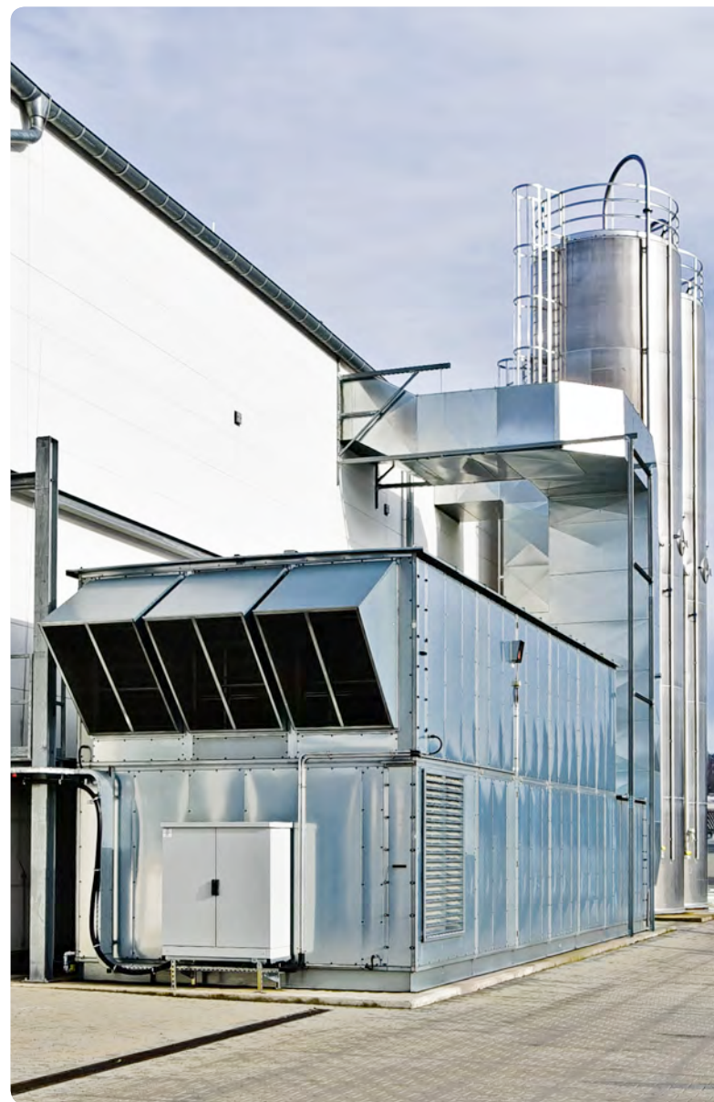
Freikühlanlagen, Wärmetauscher, Kühlturm, Kältemaschinen, Heizungssysteme für verschiedene Bereiche – im unternehmensweiten Energiekonzept schaltet Heinlein automatisch die situativ optimalen Technologien zusammen. (Bild: Meinolf Droege)
