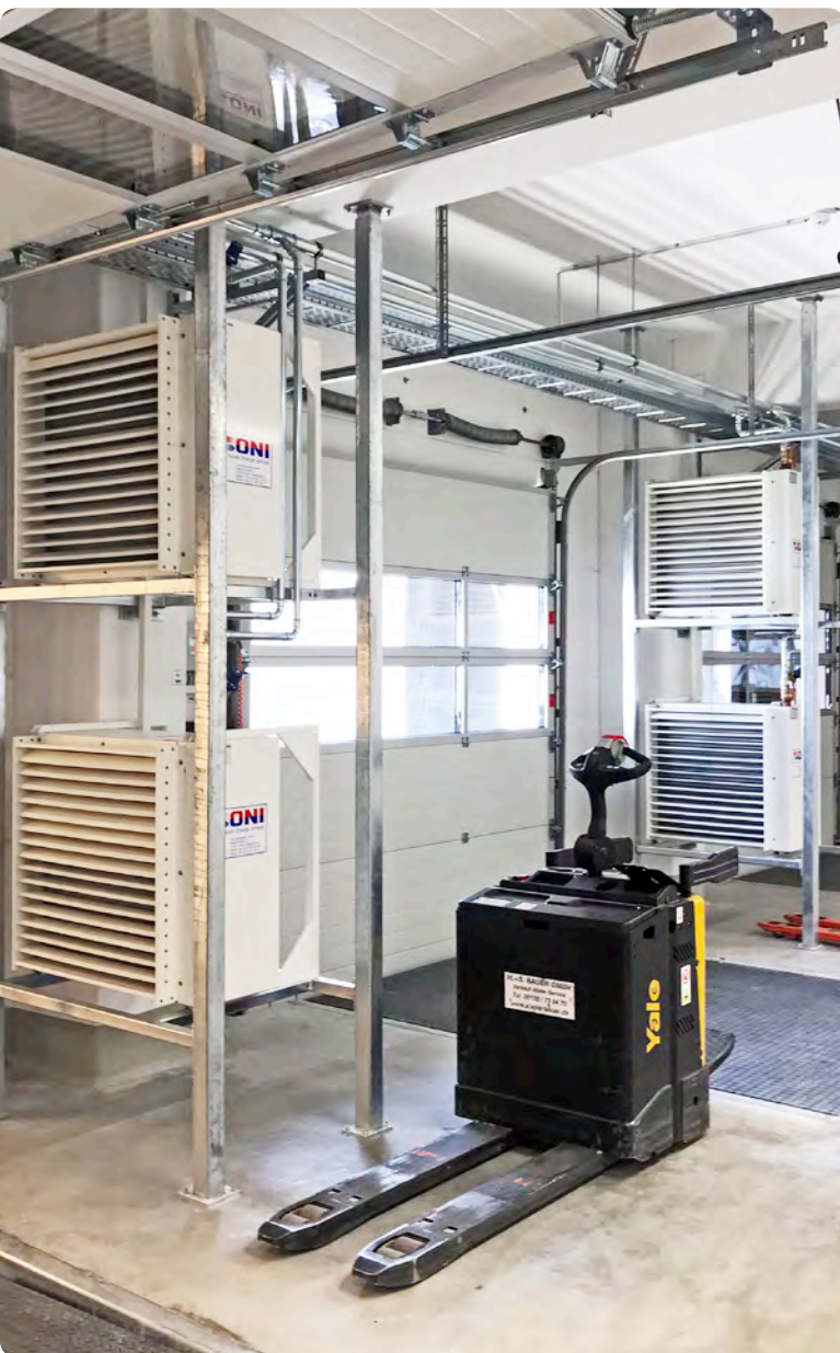
Torluftschleier sind eine elegante Methode, Logistikwege frei zu halten. Die sonst energieaufwändige Technik wird hier ebenfalls aus der Wärme-Rückgewinnung gespeist. (Bild: Oni)
