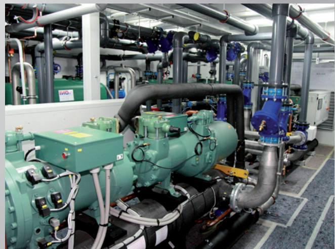
Blick in eine energieoptimierte Containerkühlanlage mit wassergekühlter Kältemaschine. View to an energy-optimized container cooling system with a water cooled chiller.
