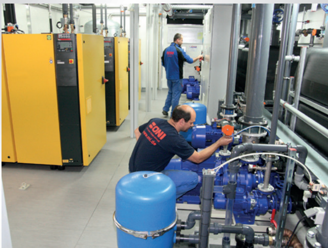
Container-Kühlanlage in Kombination mit einer zentralen Druckluft- Erzeugungsanlage mit Wärmerückgewinnung Container cooling system in combination with a central Compressed- air generating system with heat recovery
