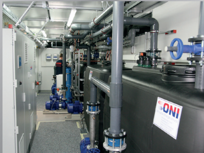
Endmontagephase einer modularen Energiezentrale zur Versorgung eines 2-Kreis-Kühlsystems bei einem Metallverarbeiter. Final assembly phase of a modular power station to supply a 2-circuit cooling system for a metal processor.
