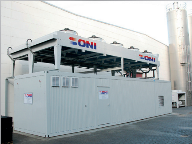
Zentralmodul einer Energiezentrale mit aufgesetzten, glykolfreien Freikühlern für ein Zweikreis-Kühlsystem mit Winterentlastung. Central module of an energy center with glycol-free outdoor coolers on the top for a double-circuit cooling system with winter relief.
