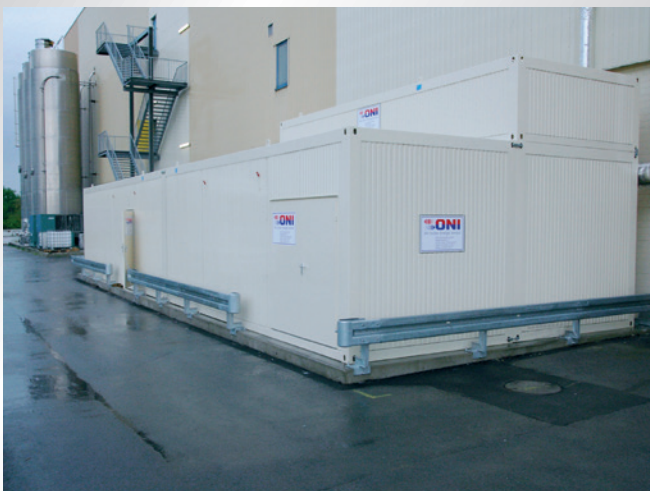
Blick auf eine aus 5 Modulen bestehende Container-Energiezentrale für mehrere Kühlkreisläufe bei einem Hersteller für Spezialpapiere. View of a container power station, consisting of 5 modules for several cooling circuits for a manufacturer of specialty papers.
