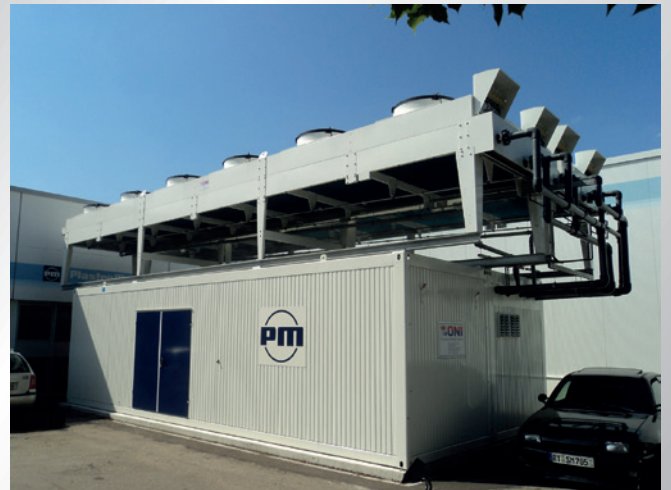
Beispiel für eine modulare Doppelcontainer-Energiezentrale bei einem Kunststoffverarbeiter aus dem Bereich Spritzguss/Systemtechnik.
