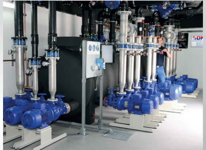
Blick in eine große Container-Kühlanlage, für einen Metall verarbeitenden Betrieb, die aus mehreren Modulen besteht. View into a large container cooling system for a metal-working operation, which consists of several modules.
