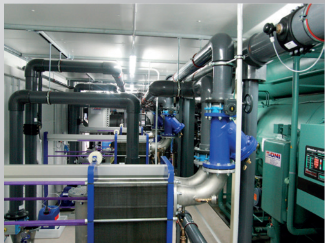
Blick in eine große, modulare Energiezentrale mit Absorptions-Kältemaschine und Wärmeaustauschereinheiten zur Systemtrennung. View into a large, modular power station with absorption refrigeration machine and heat exchanger units for system separation.
