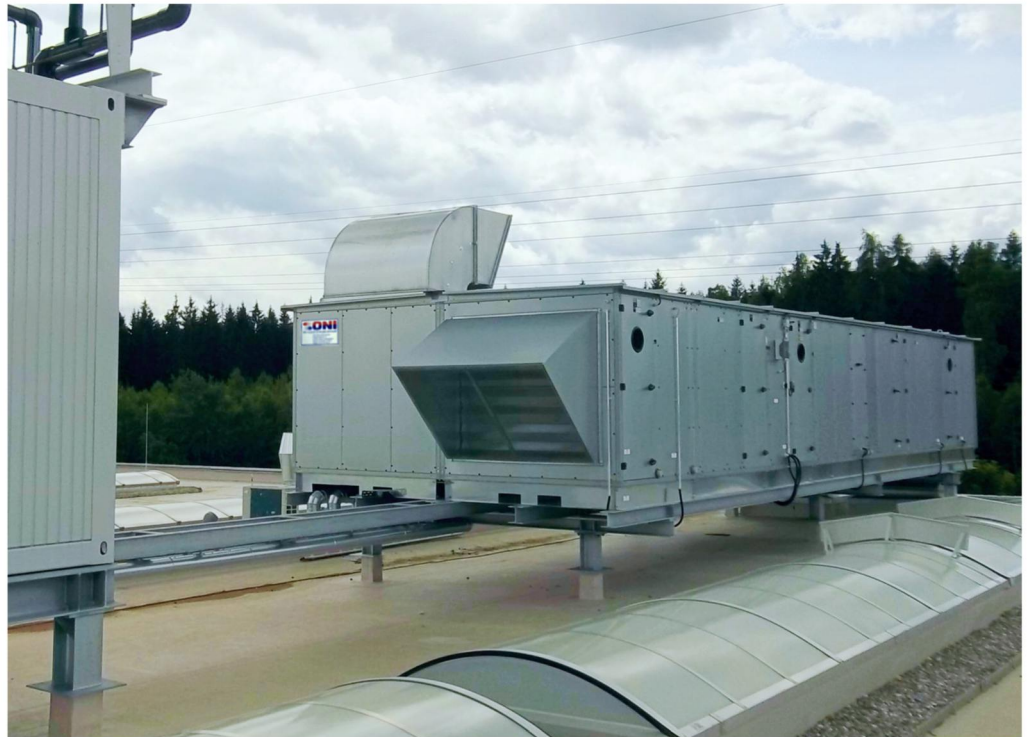
Wärmerückgewinnung sorgt für gutes Klima. Im ersten Schritt wird hier die Energie der Abluft genutzt und im zweiten Schritt die kostenlose Maschinenabwärme. Ein Beispiel für optimale Energienutzung! Foto: ONI
