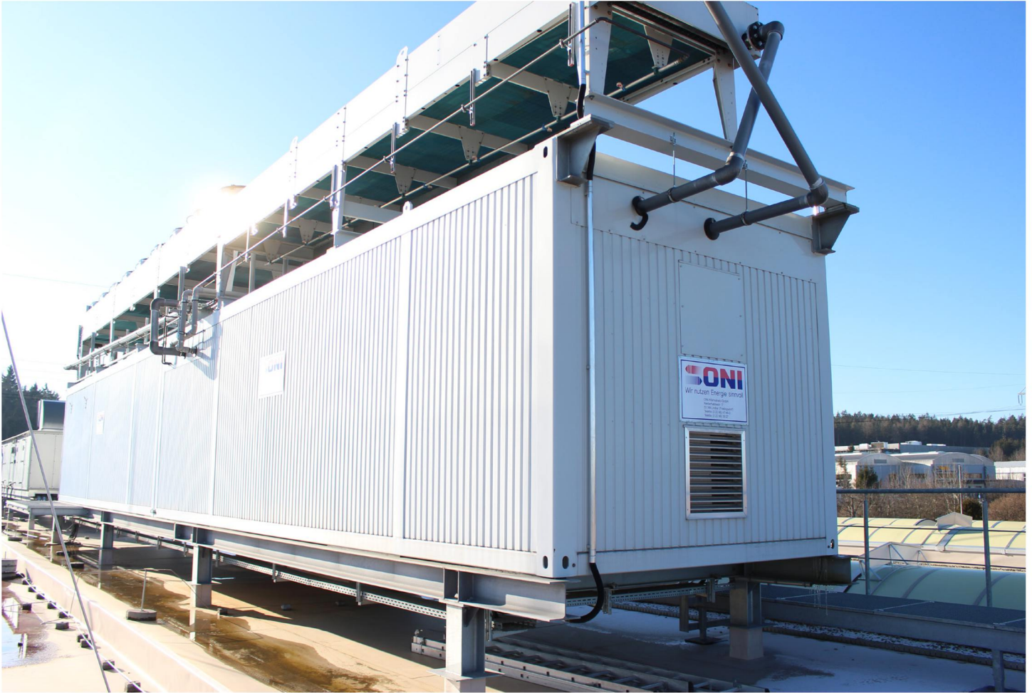
Blick auf die Oni-Kühlanlagentechnik auf dem Hallendach am Produktionsstandort in Mönchweiler. Mit Oni-Technik konnte KE-Technik Energie- und Betriebskosten auf ein Minimalmaß reduzieren. Foto: K-ZEITUNG/Bechlarz
