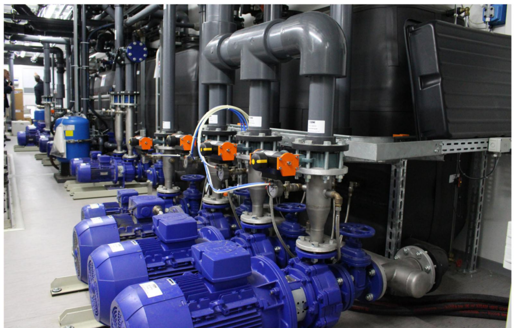
Blick auf die Zweikreis-Pumpen-Tankeinheit mit Wärmerückgewinnungssystem in der Doppelcontainer-Energiezentrale. Foto: K-ZEITUNG/Bechlarz
