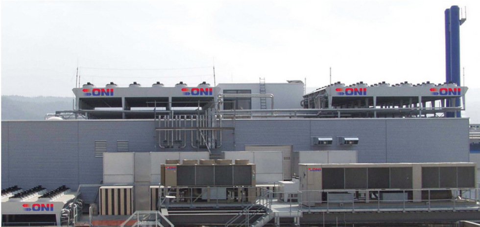
Energieoptimierte Kühlanlagentechnik mit Wärmerückgewinnung in einem großen Medizintechnikunternehmen.
