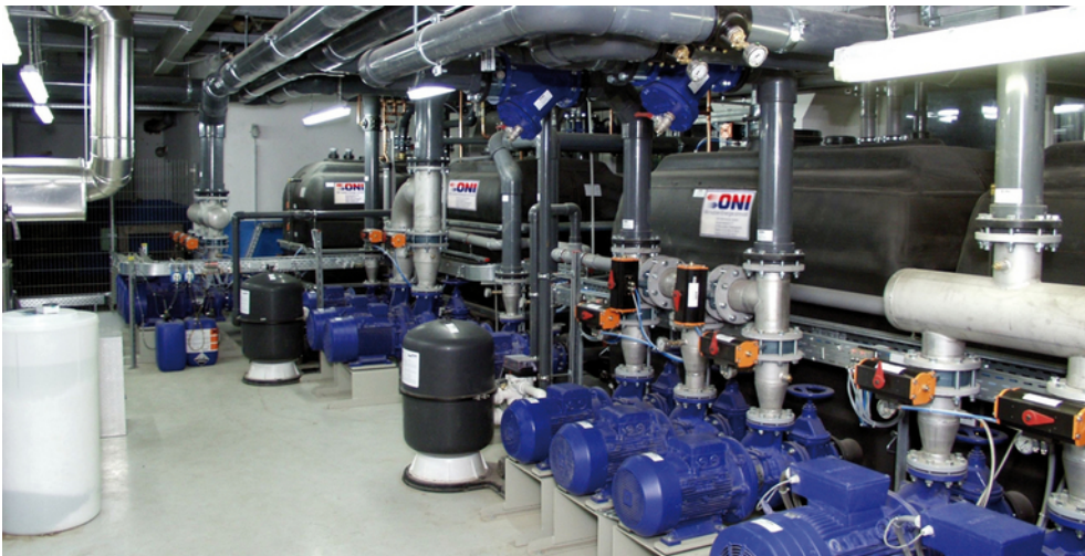
Kühlagententechnik mit Wärmerückgewinnung von ONI in einem großen Kunststoffbetrieb
