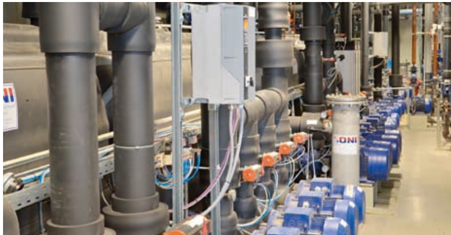
Hier schlägt das Herz der Energieeinsparung bei ZKW – mehrere Kühlkreise werden besonders energieeffizient genutzt. Eine intelligente Steuerung sorgt für die situativ jeweils optimale Nutzung und sorgt für hohe Prozesssicherheit.
