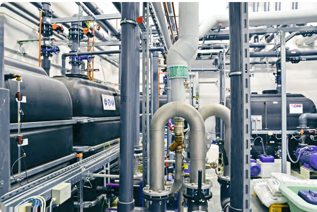
Die Zentrale der Energiesparteknik von Oni ist kompakt und wartungsfreundlich in einem zentralen Raum untergebracht.
