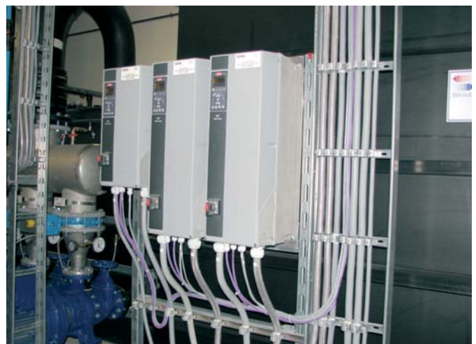
Frequenzgeregelter Pumpen stellen sicher, dass in jedem Betriebszustand die Kühlwasserversorgung mit möglichst wenig Energieaufwand realisiert wird.
