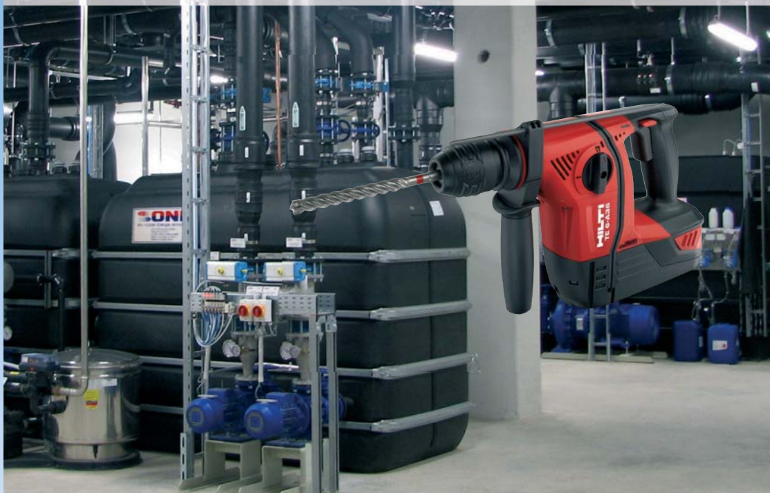
Teilansicht der Kühlwasserversorgung für die Formkühlung der Spritzgießmaschinen mit Energiesparschaltung über eine Winterentlastung in der Hilti Kunststofftechnik GmbH (eingeklinkt: Akku-Bohrhammer »TE 4-A36 AVR«). Foto: Hilti) Fotos: ONI.
