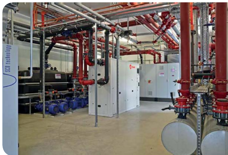
Trotz der Komplexität ist die „Energiesparzentrale“ bei Schneegans-Freudenberg sehr kompakt und wartungsfreundlich. (Bild: Droege)
