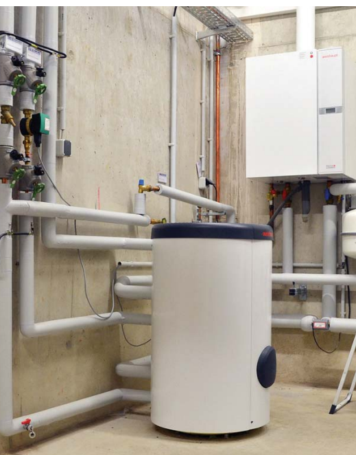
Keine Chance für Gaslieferanten – mehr konventionelle Heiztechnik findet sich in den umfangreichen Neubauten der Müller-Technik nicht mehr.
