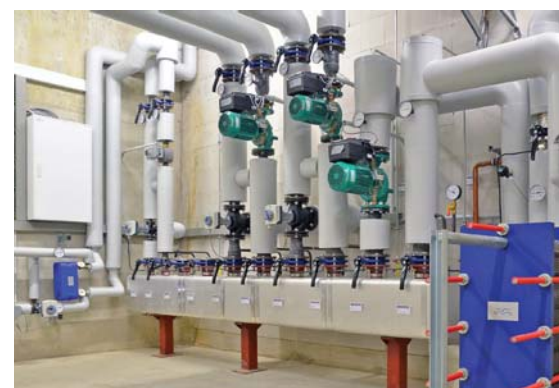
Klare, einfache Strukturen bestimmen die Infrastruktur der Wärme- und Kälteversorgung.
