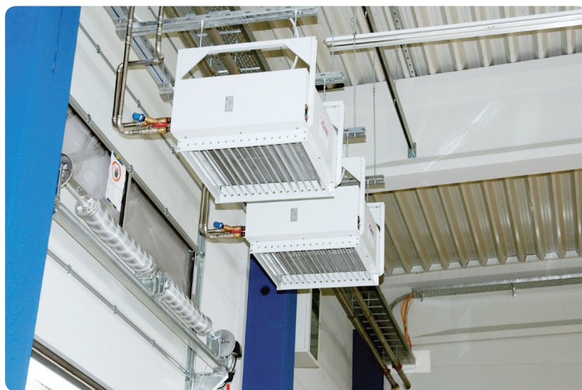
Torluftschleier vermindern das Einströmen von Kaltluft in die Halle bei geöffnetem Tor. (Bild: Oni)
