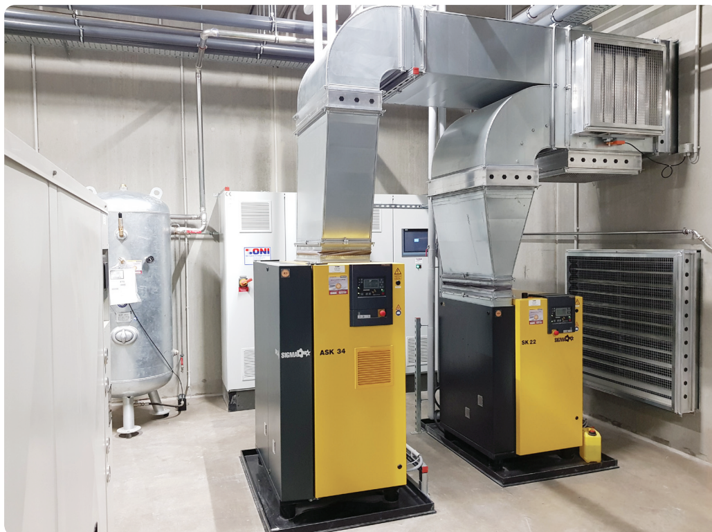
Auch die Druckluftanlage ist in die Spartechnik integriert – die Abwärme der Kompressoren fließt in die Beheizung ein. Das Temperaturniveau ist ausreichend, um eine hygiesichere Trinkwasserversorgung mit 60 Grad Celsius sicherstellen zu können. (Bild: Oni)
