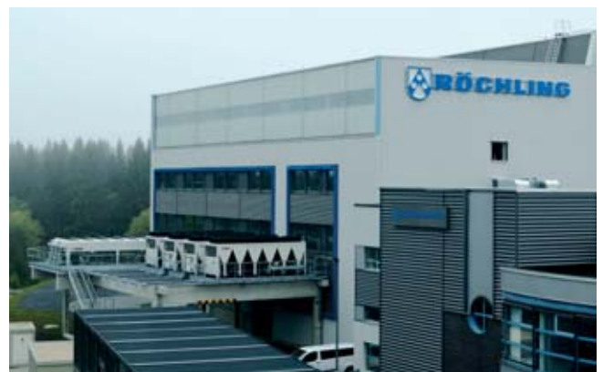
Blick auf die aufgeständerte Technik vor dem Hallenneubau.
