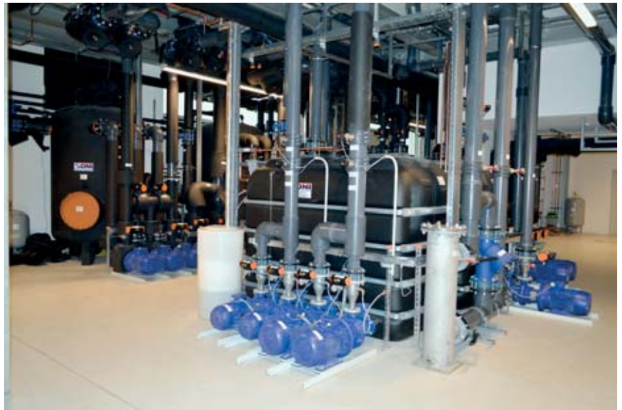
Die Pumpen-Tankeinheit im Neubau am Röchling-Standort Neuhaus.
