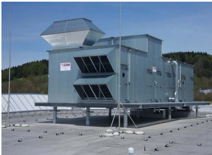
Mit dem neuen Heizwärmekonzept von ONI konnte AVS die bei Einsatz üblicher Technik entstehenden Heizenergiekosten um circa 90 Prozent reduzieren. Bilder: ONI
