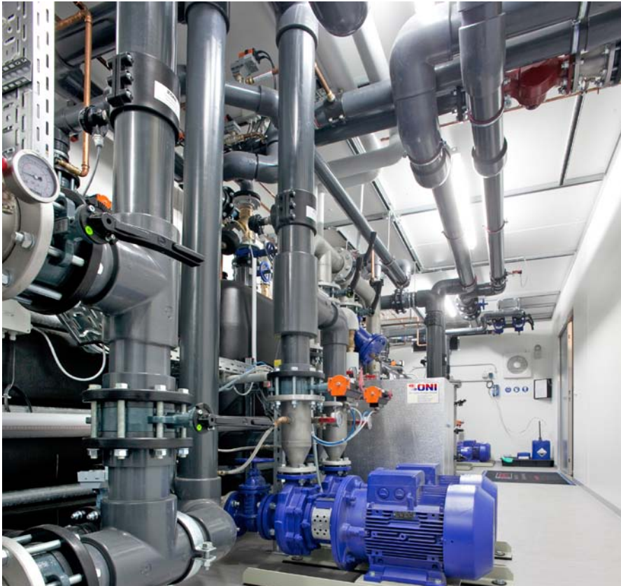
Die gesamte Energietechnik ist kompakt in einem Container untergebracht.
