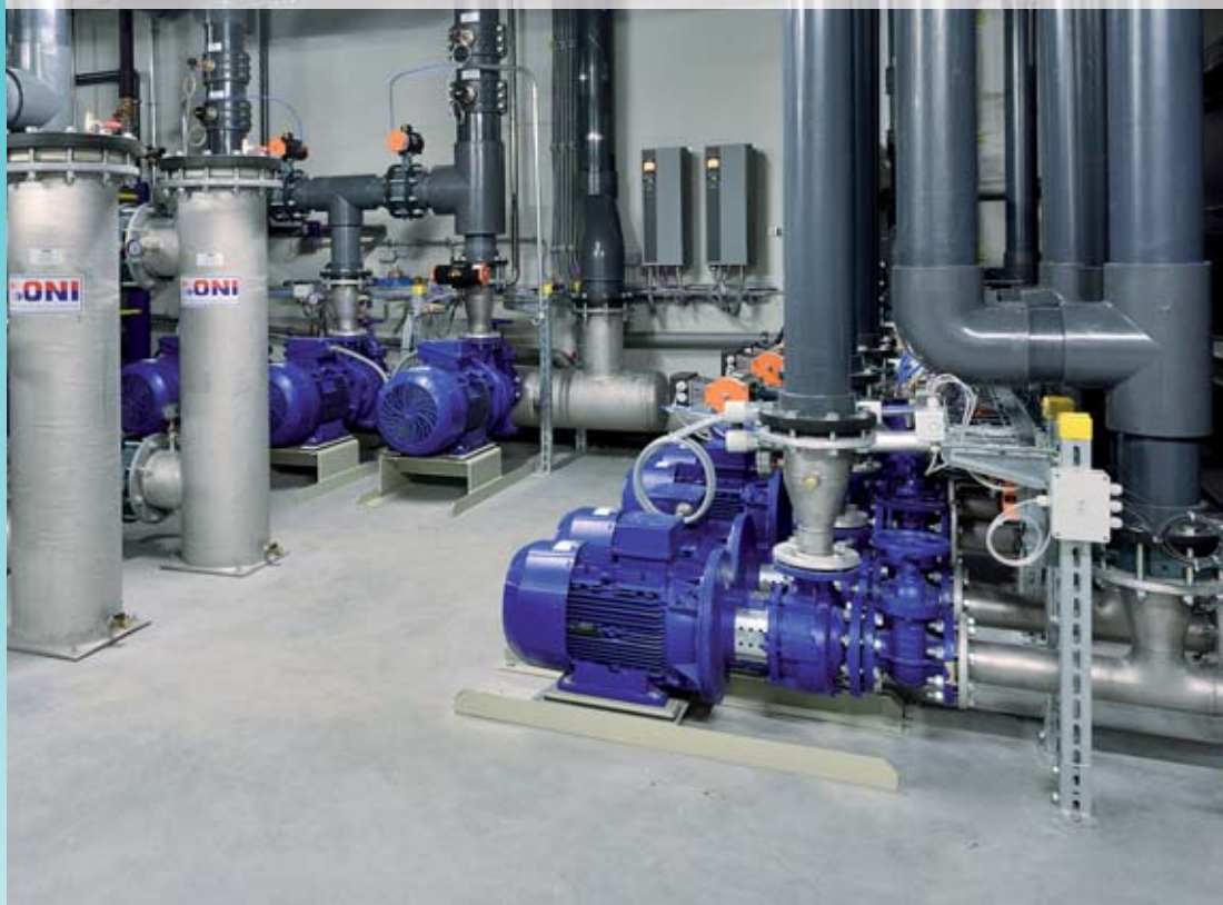
Teilbereich der ZKW-Technikzentrale mit Pumpengruppen, Wärmetauscher- und Filtereinheiten für den Rückkühlkreislauf. Bilder: ONI
