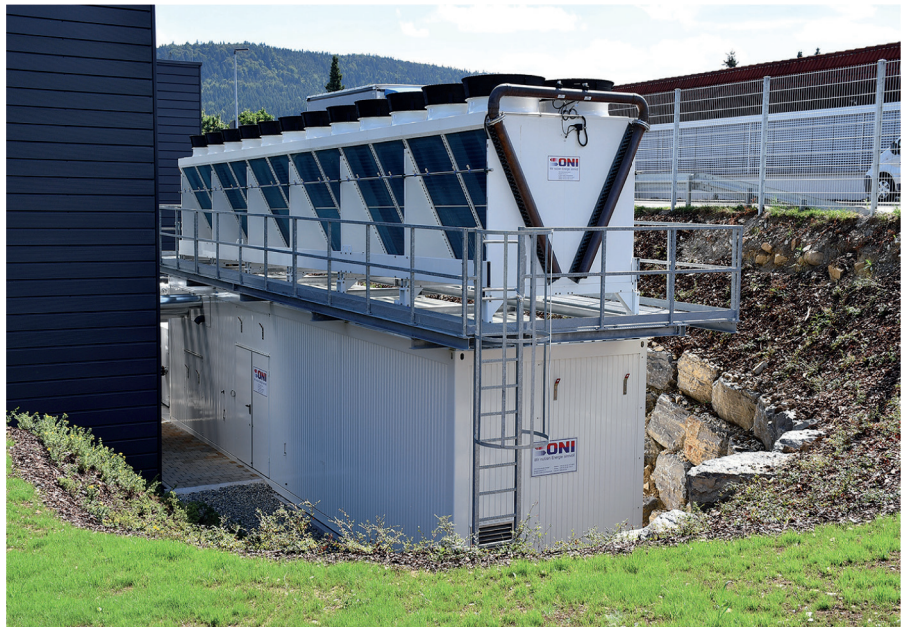
Container-Kühlanlage mit aufgesetztem V-Freikühler.
